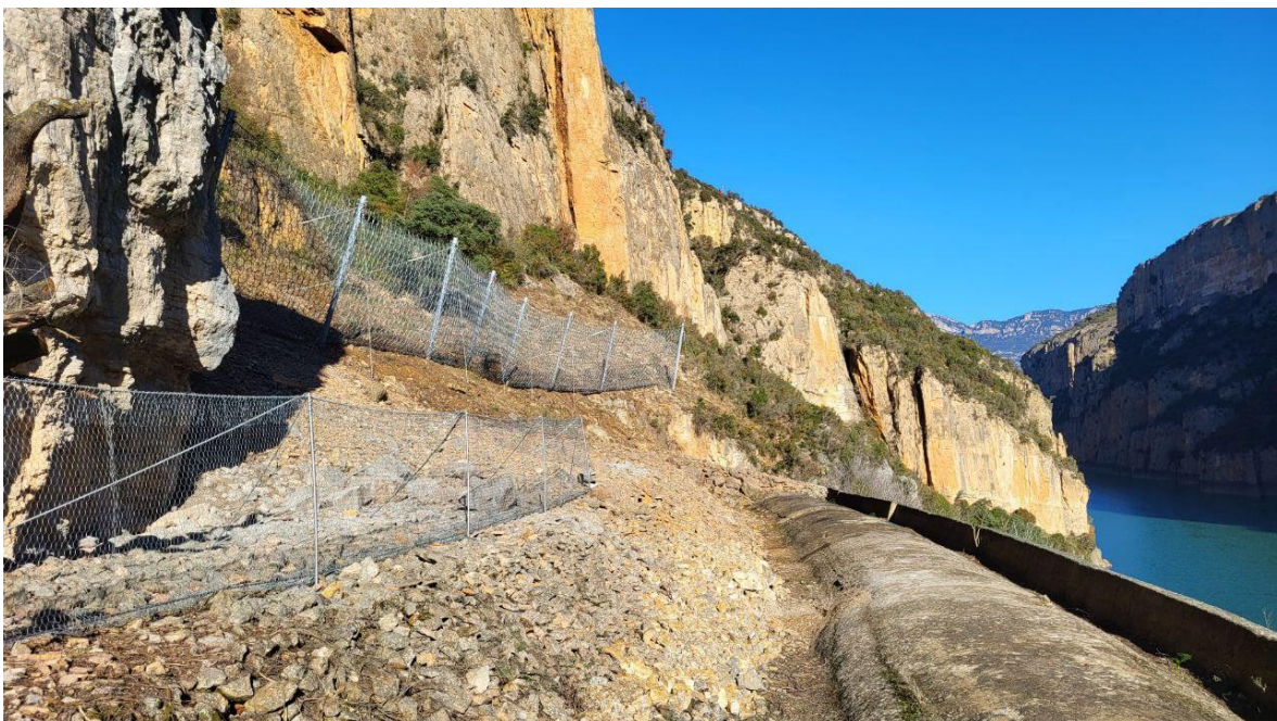
Barreres instal·lades a la part superior del túnel, per frenar futures esllavissades
