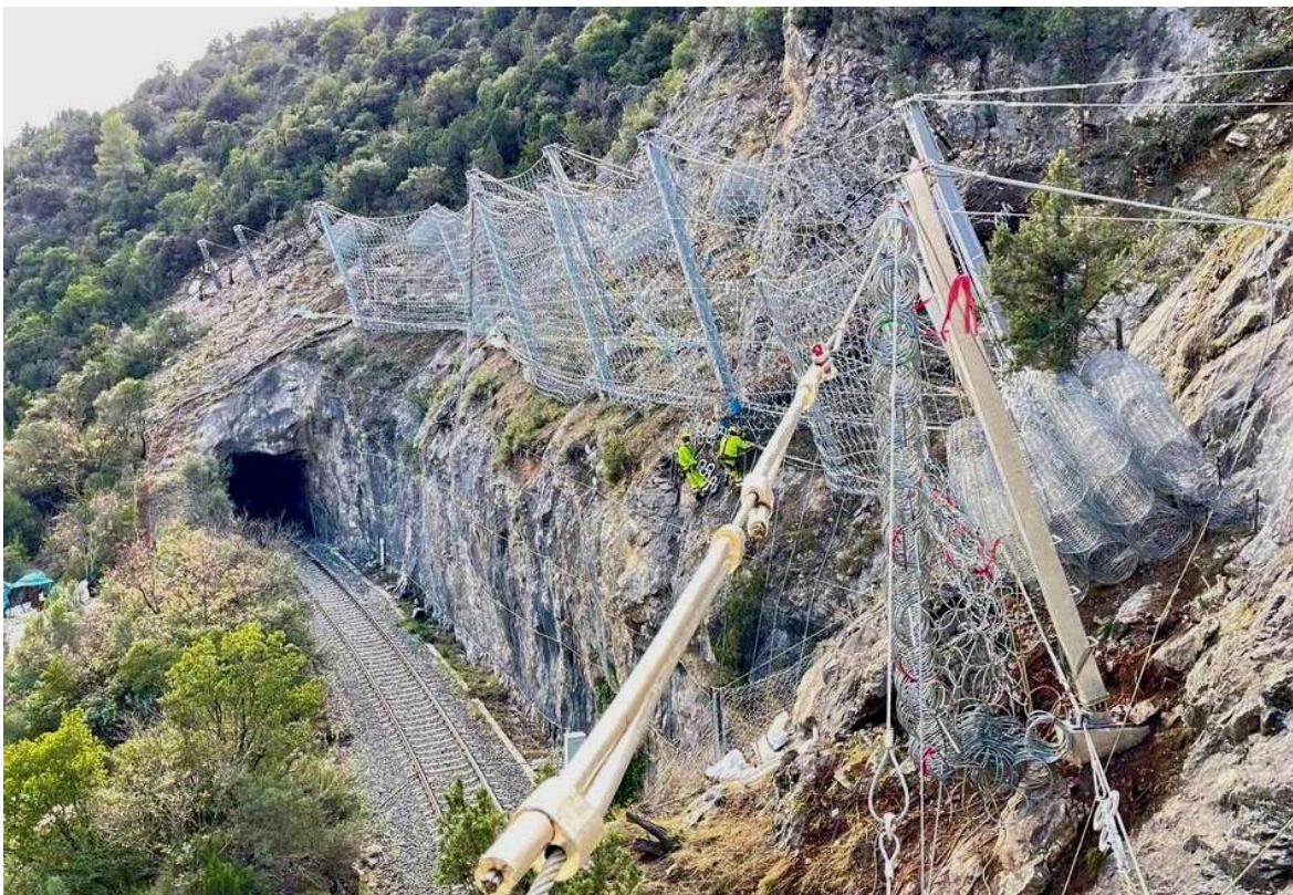
Barreres dinàmiques instal·lades en un altre dels vessants de la línia.
